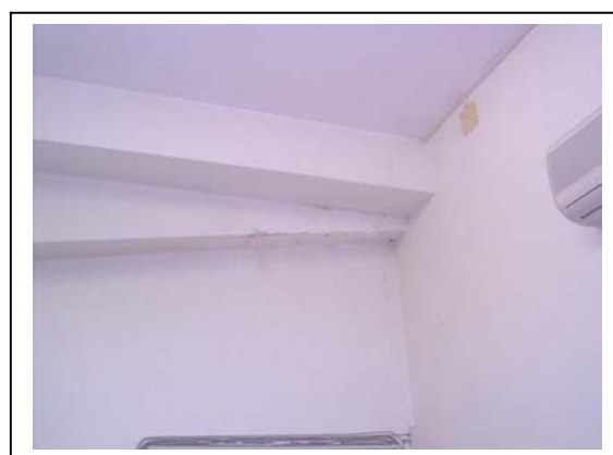
Foto n. 27/28 -Infiltrazioni d'acqua e di umidità nella Sala Consigliare
